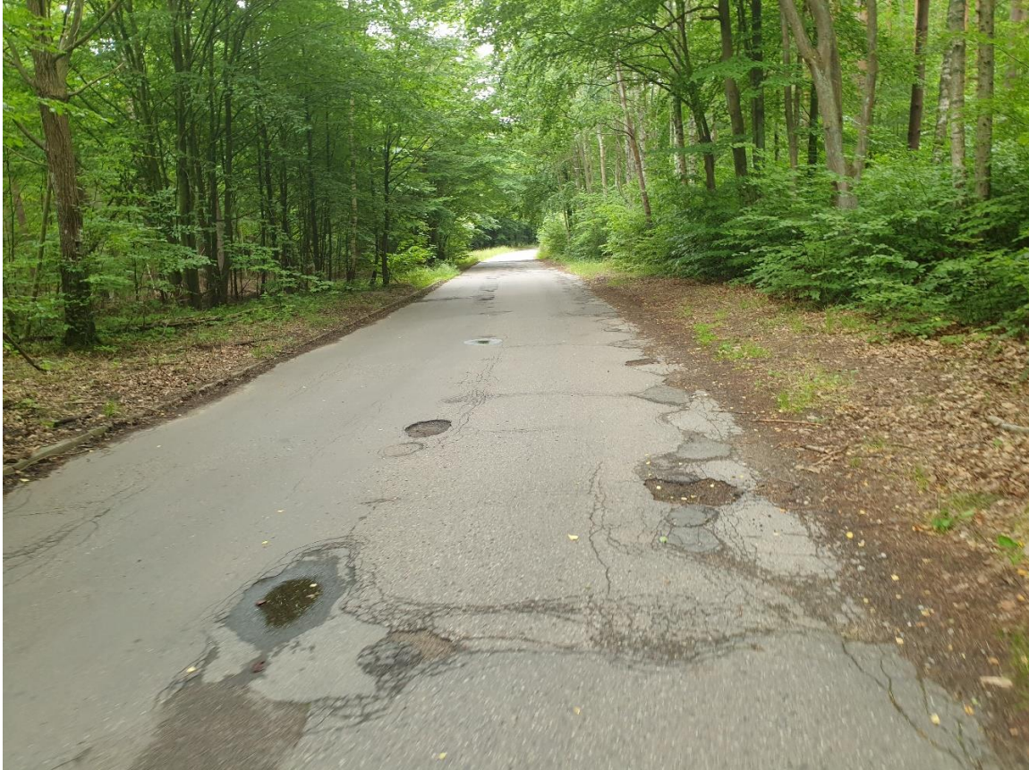
Rysunek 5. Ulica komandora. Sakowicza w kierunku jednostki wojskowej; po prawej stronie widoczny krawężnik, nawierzchnia zniszczona przez odpływającą wodę deszczową.
