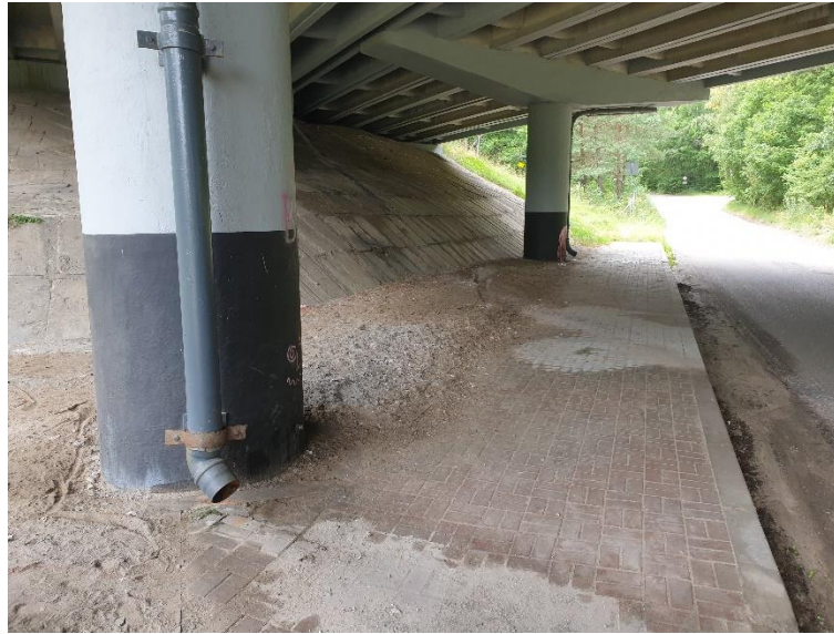
Rysunek 7. Odprowadzenie kanalizacji deszczowej z wiaduktu obwodnicy trójmiejskiej, widok w górę zlewni; na poboczu drogi widoczne odsypisko piachu wypłukanego z rur spustowych – powyżej wiaduktu nie stwierdzono piachy na jedni.
